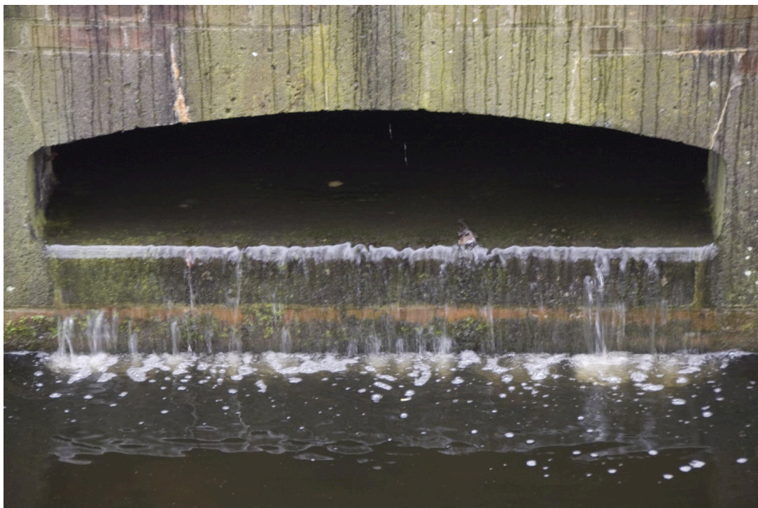
Riooloverstort (foto: GAW/Stichting RIONED).
